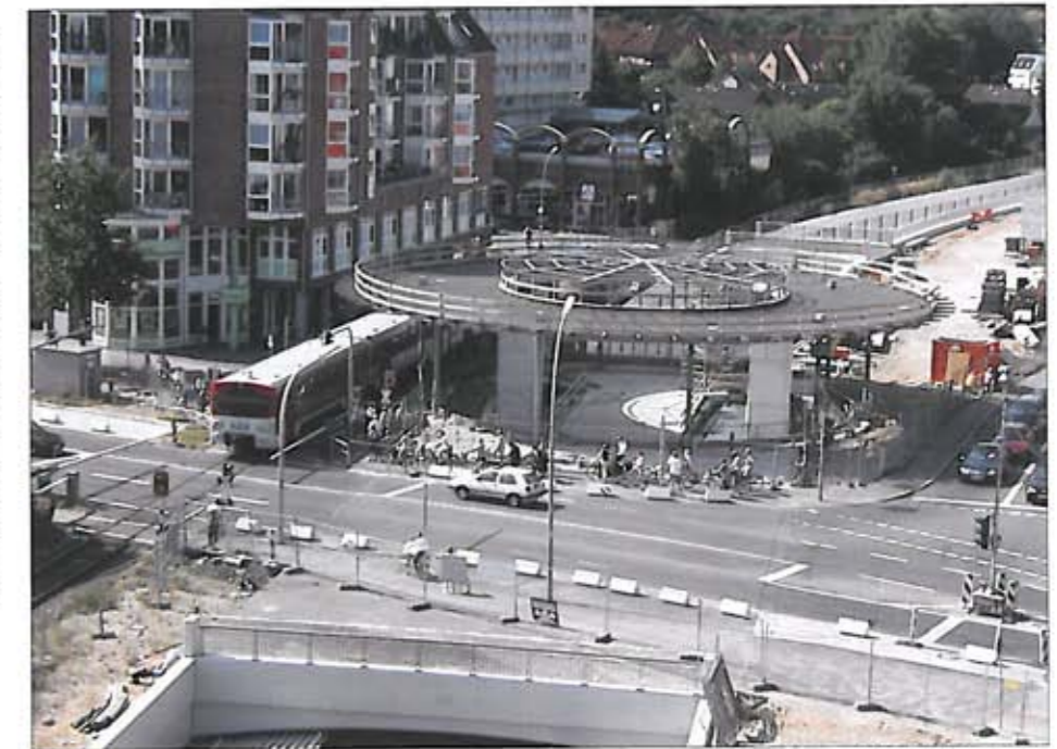
Bild 10: Beispiel für Bauzustände zur Tieferlegung der AKN-Trasse mit Zweigleisigkeit: AKN-Triebwagen auf alter Trasse neben dem Trogbauwerk und der Rotunde für den Bahnhof Eidelstedt Zentrum
